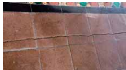
Riss im Boden des Chorraums
