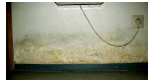
Durchfeuchtung im Keller
