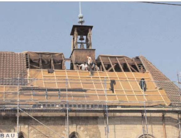
Das Dach wurde abgedeckt und mit einer schweren Gewebefolie gesichert, damit sofort wieder ein Regenschutz vorhanden war.
