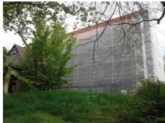
So sieht die Baustelle seit April 2016 aus: Die Katharinenkirche, von der Katharinenstraße aus gesehen
